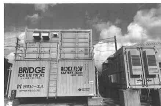
写真 - 8 蓄電池 (RF 電池)
